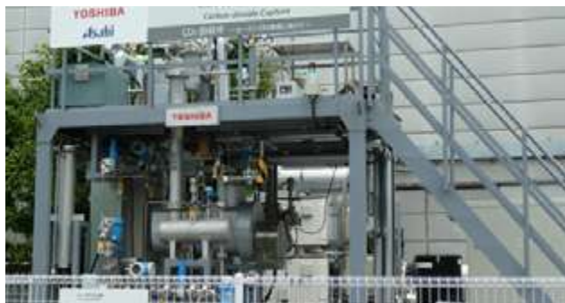
CO 2 分離回収試験装置
