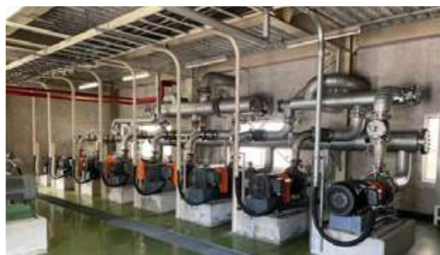
水処理設備(名古屋工場)
